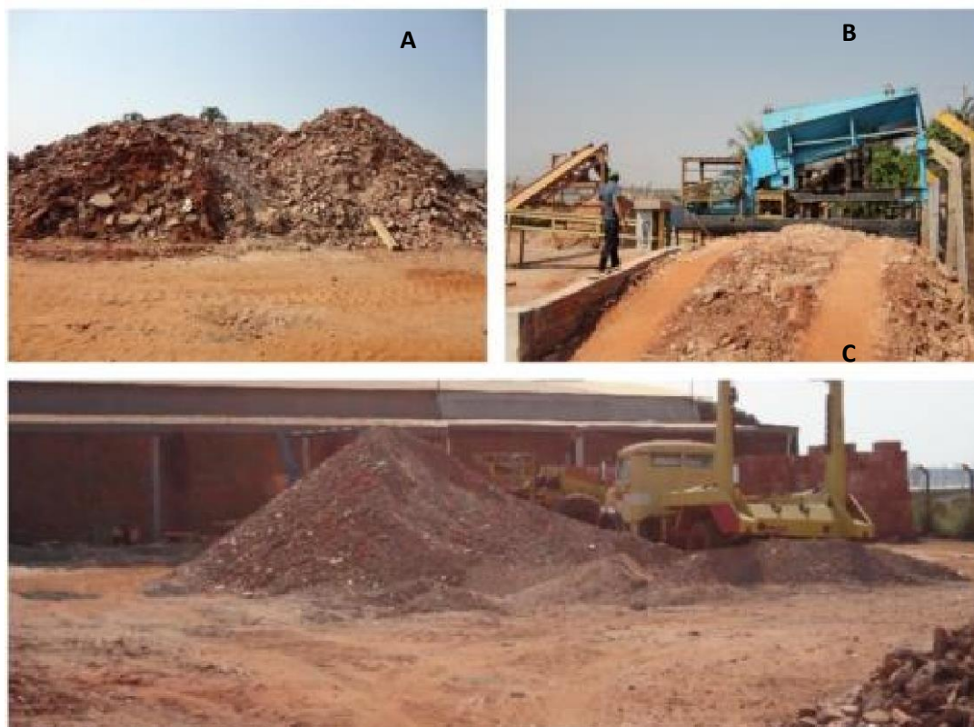
Figura 22 – Empresa Jato de Areia Frutalense, usina de moagem dos RCD em Frutal-MG. Fonte: ROMIO, 2014.
